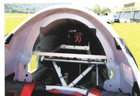
▲ Derrière le pilote, les batteries et leur contrôleur.
